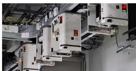
クリーンルーム内搬送装置
