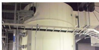
排ガス洗浄装置
