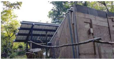
太陽光発電システムを設置
