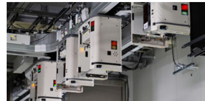
クリーンルーム内搬送装置
